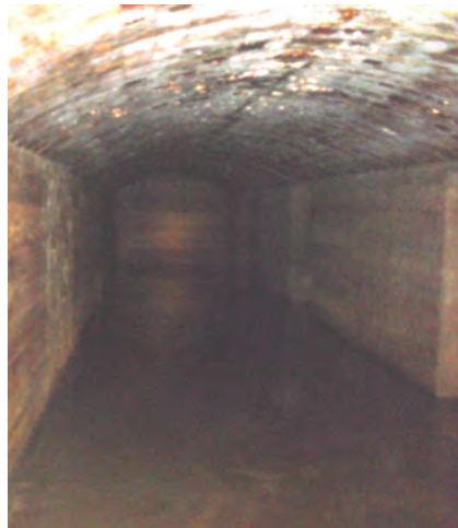
En aquesta foto es veu el refugi ple d'aigua, ja que quan el van trobar estava en aquestes condicions i posteriorment el van fer servir de dipòsit.
