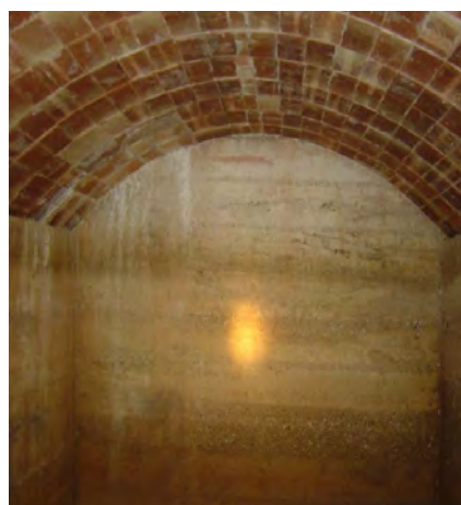
En aquesta paret del refugi, es pot veure on arribava l'aigua. Font: Pere Artigas, responsable d'HSE i Serveis de la fàbrica.
