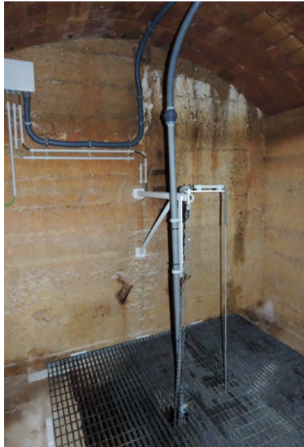
En aquesta foto es veu un pou que han construït actualment per treure l'aigua que hi neix. Quan van construir el refugi aquí s'hi trobaven els lavabos. Foto feta per Gemma Ribalta.
