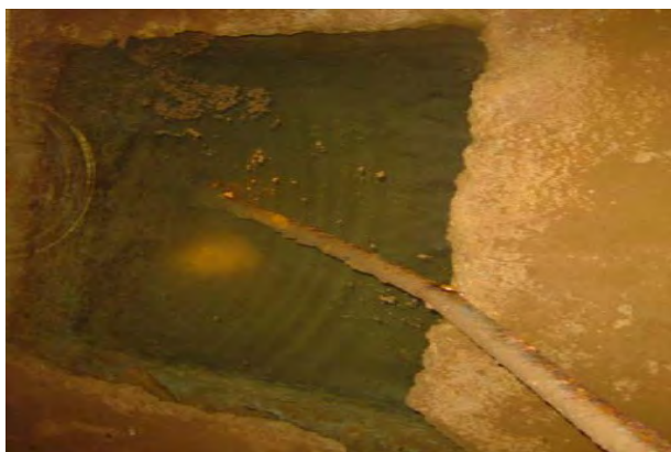
Imatge del refugi de la Pirelli, ple d'aigua. Font: Pere Artigas, responsable d'HSE i Serveis de la fàbrica.
