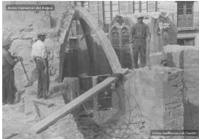
Imatge de l'església de Sant Miquel durant l'enderrocament. Font: Arxiu Comarcal del Bages.
