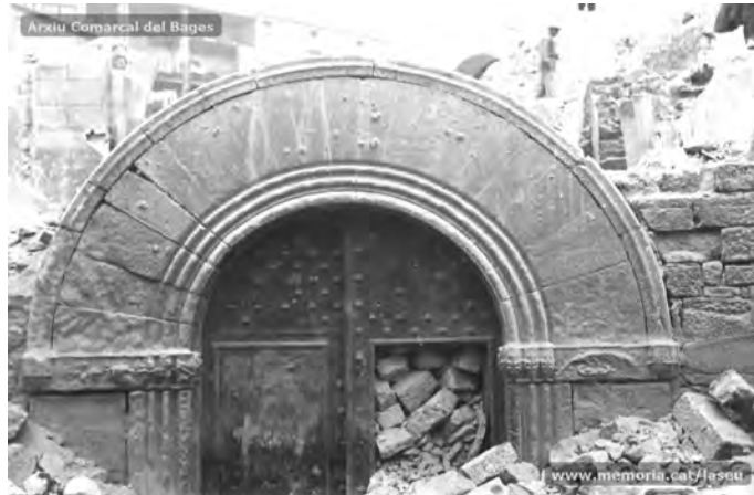
La porta de l'església mentre aquesta estava sent enderrocada. Font: Arxiu Comarcal del Bages.
