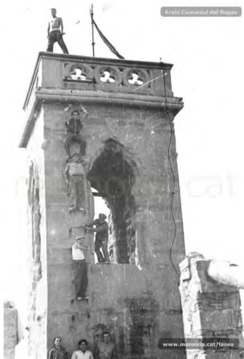
Imatge de l'enderrocament del campanar de l'església del Carme. Font: Arxiu Comarcal.
